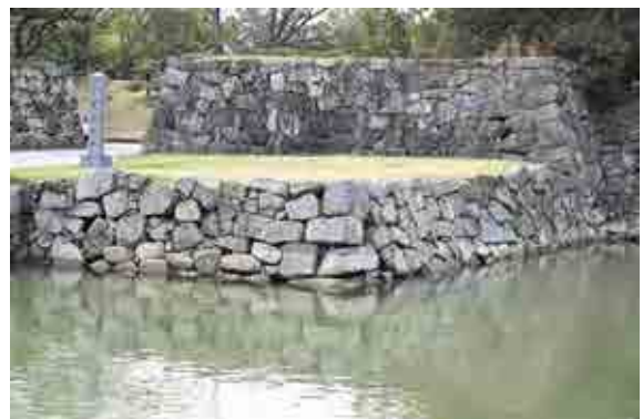
出隅部の変状により周辺に緩みが生じている。
