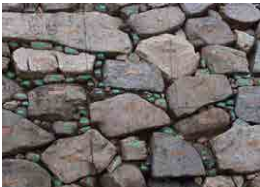
他城郭の事例： 背面からのほらみ出しにより間詰石ごと目地が開いている状態。
