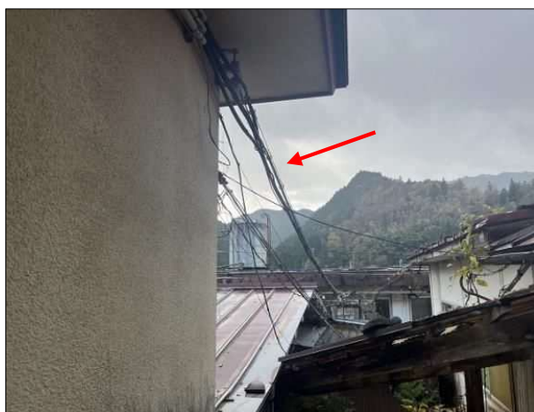
ケーブル・配管
